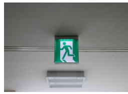
避難口誘導灯
