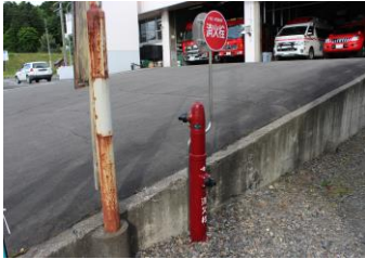
町内で 消火栓 90基
